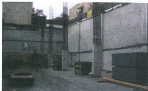
شکل ۴: عملیات شاتکریتی اجرا و تمام شده است. دیوار کامل‌شده شامل تیوپ‌هایی است که گروت ضدآب به داخل آن‌ها تزریق خواهد شد.
